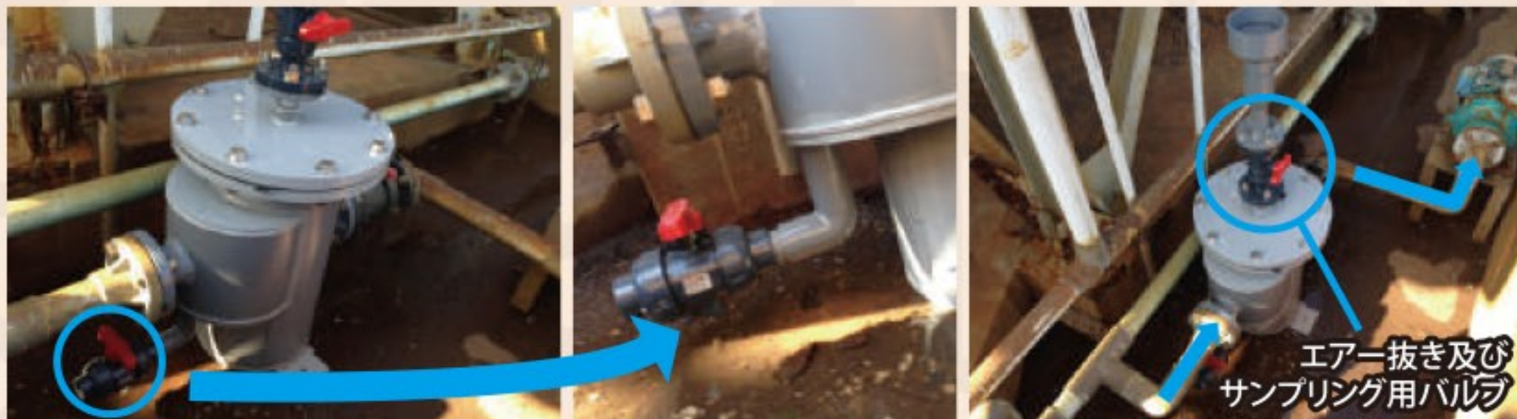
第一層目のスラッジ排出はドレンバルブをひねるだけ。
